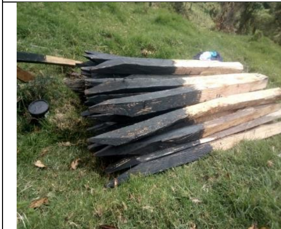
Imagen 14. Puesta a punto de pateadura para la construcción del sistema silvopastoril, predio Miravalle.
